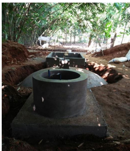
Gambar 1. Digester biogas di Desa Kediri
