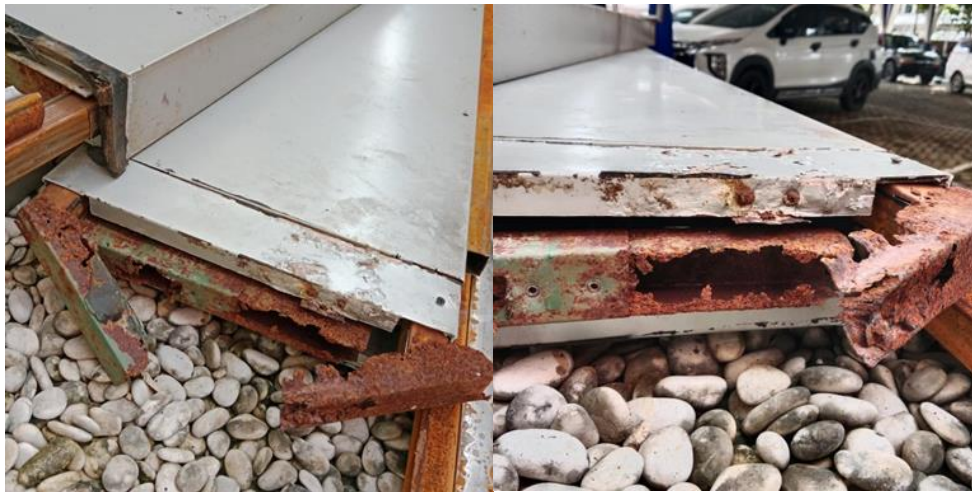
Gambar 5. Korosi pada Rangka ACP Gedung Kanwil DJP Bengkulu - Lampung
