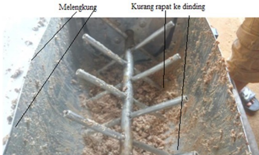
Gambar 8. Bak penampung dengan konstruksi tidak presisi terutama pada penekukan dan pelengkungan pelat.
